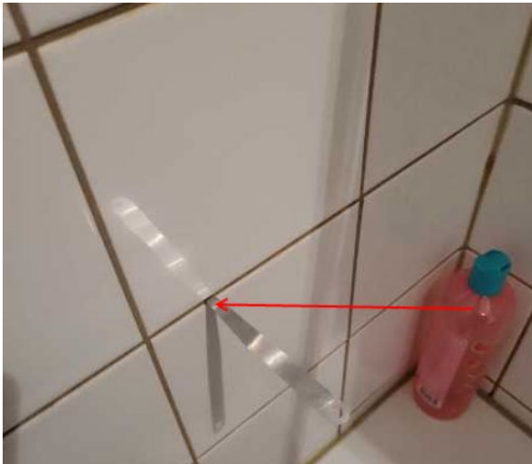
Openstaande voegwerk douchehoek
