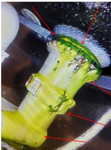
Endoscopisch onderzoek onder de douchebak wijst uit dat de groene kleurstof direct zichtbaar wordt langs de sifon van de douchebak
