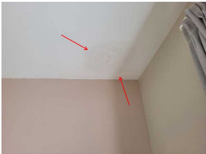
Vochtschade in de woonkamer
