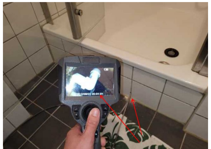
Endoscopisch onderzoek onder de douchebak wijst uit dat de groene kleurstof direct zichtbaar wordt langs de sifon van de douchebak
